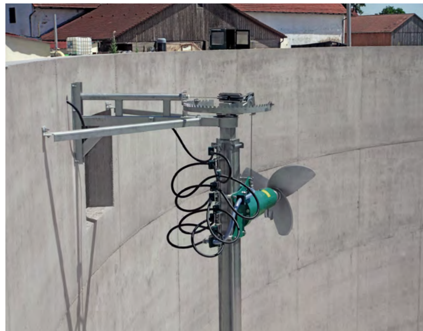
MGD - Betonbehälter mit 2G
