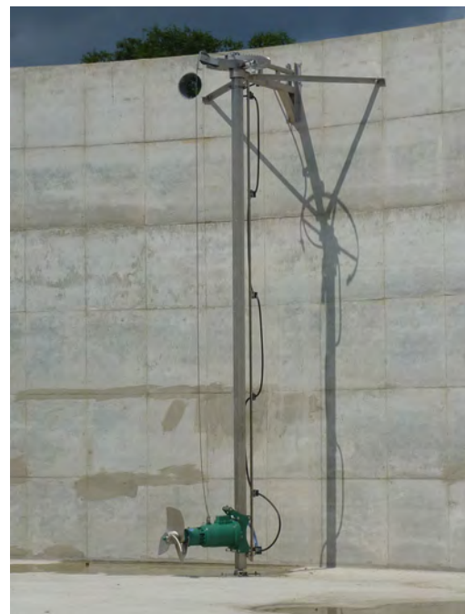
MGD - Betonbehälter mit 2G
